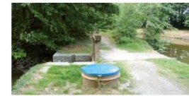
Pompe du Bois-Magné sur l'étang de Bazouges permettant d'alimenter en eau le bief de partage.
